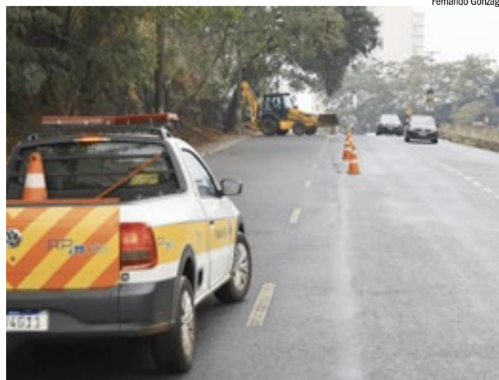
Defesa Civil Municipal apontou a possibilidade de deslizamentos
