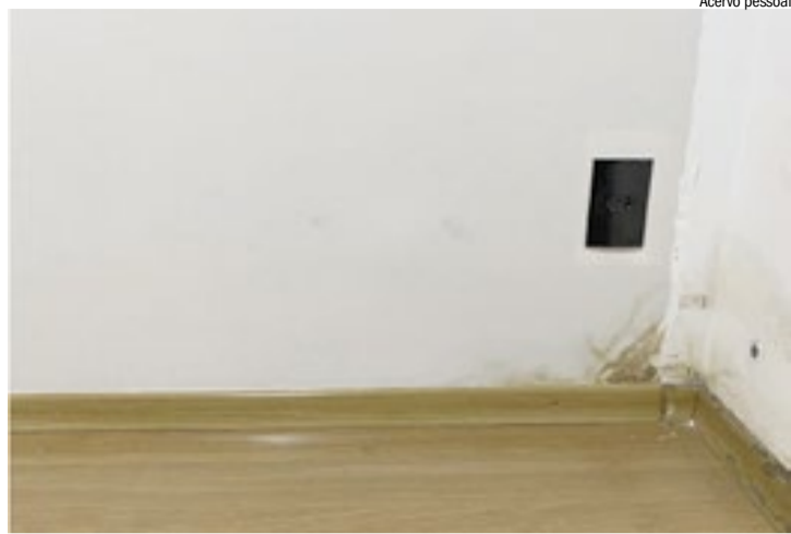
Manchas de infiltração em apartamento recém-entregue pela MRV
