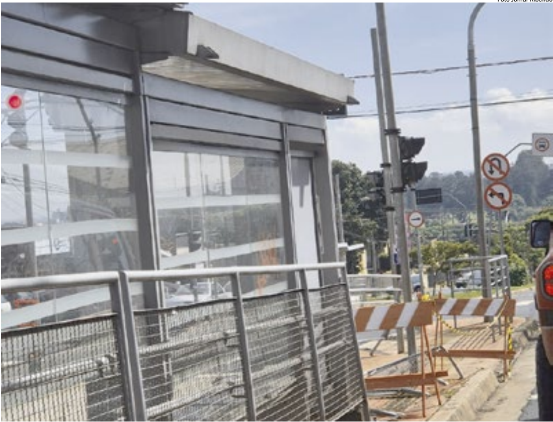
Corredor Meira Junior, com gradil e abrigo danificados, que aguardam estudo da secretaria para reparos
